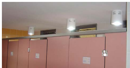
圖 3-12 廁間之照明裝置
