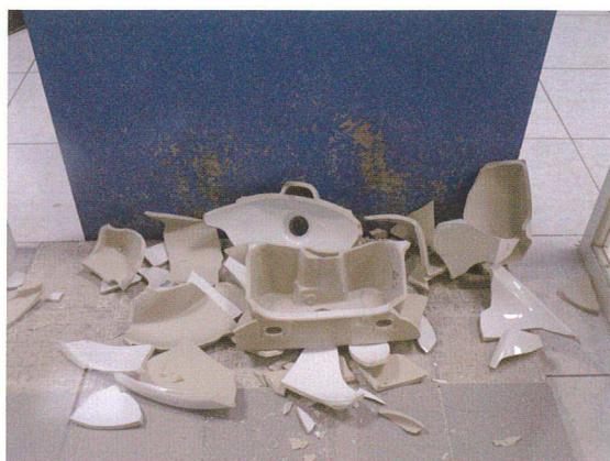
一般洗臉盆易崩裂及爆裂現象
