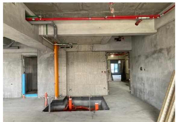
▲同層排水配管
